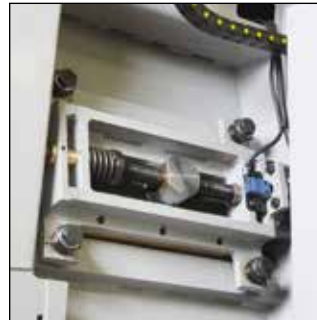
Bandspanneinrichtung durch Endschalter überwacht
